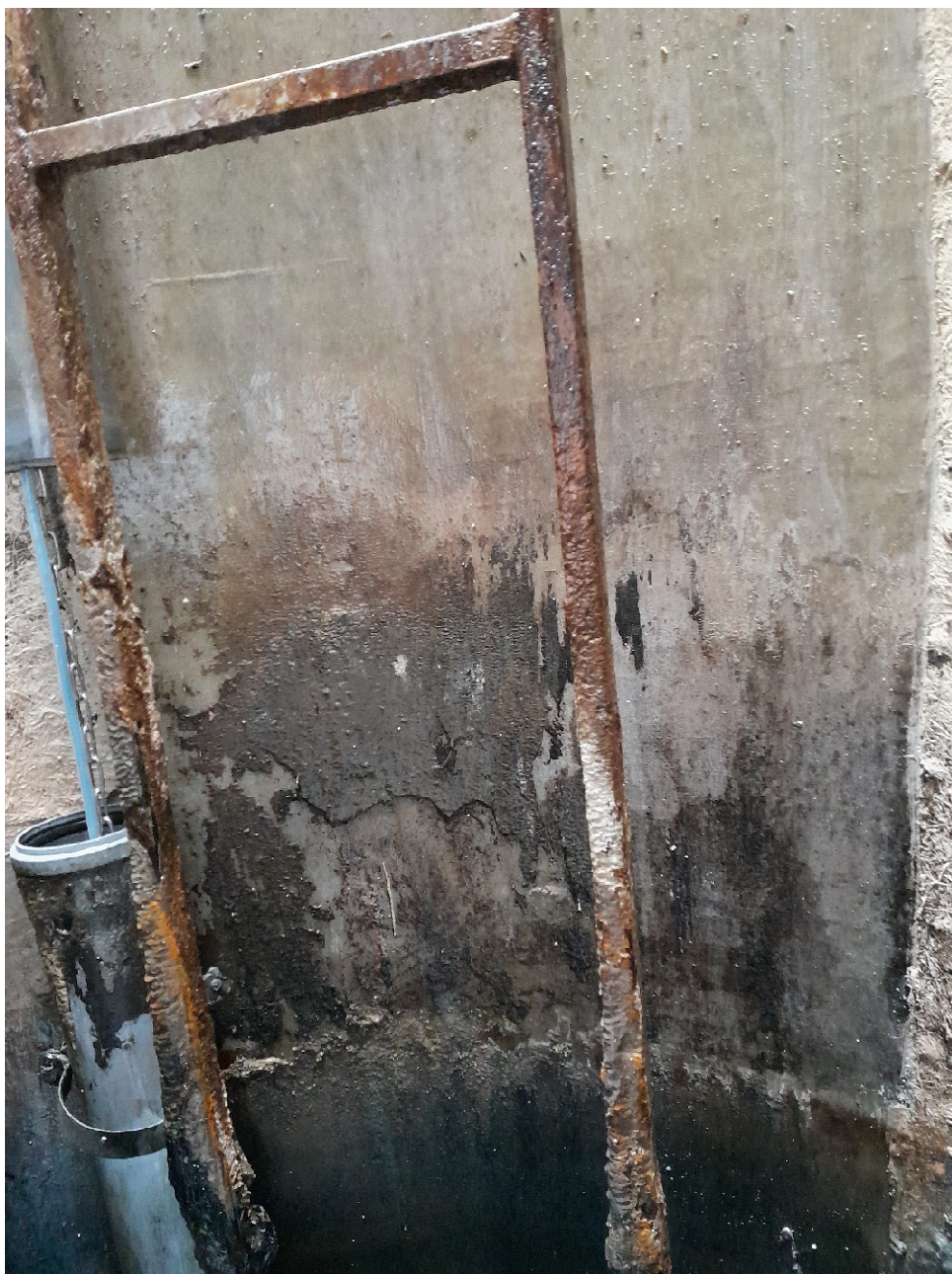
Komora przepompowni-drabina żlazowa -w dolnej części pozbawiona stopni żlazowych
