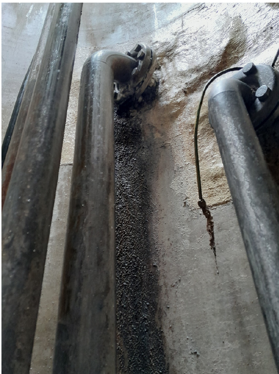
Komora przepompowni- zakończenie pionów tłocznych i rurociągu spustowego zładu
